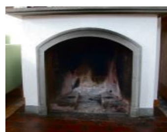
Offene Cheminéeanlagen sind ineffizient, nicht mehr zeitgemäss und belasten die Umwelt.
